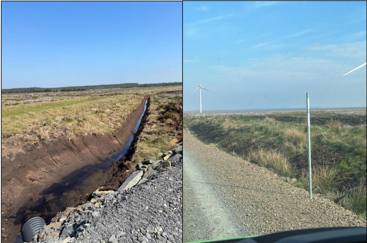
Figur 19a, b: a) Torvskråningen til høyre for veien er et eksempel på en «Peat hag». Bilde viser også tegn til at vegen har synket sammenlignet med hvor høyt myrmassene ligger i terrenget. B) Drenert grøft med bratte skråninger, beskrevet som «peat hag». Dette må dekkes til med vegetasjon for å unngå videre erosjon og tap av karbon.
