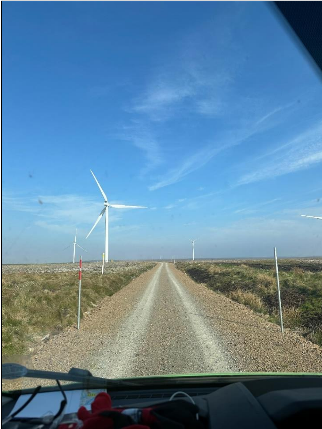
Figur 14: Flytende vei i ferdig utbygd vindmøllepark. Vegen har sunket siden etablering.
