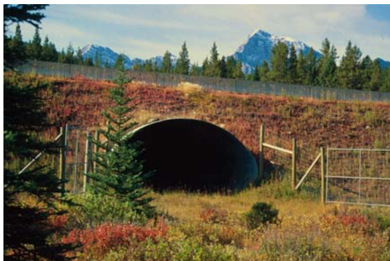
Fig. 22: Ellipseformet undergang, kulvert. H1. Her passerer både hjortevilt og bjørn
