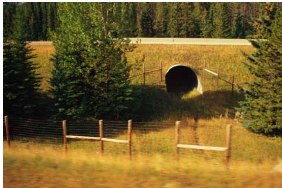
Fig. 23: Vanlig rund kulvert, metallrør, H1. På dette punktet var de to vegbanene separert med en bred "midtrabatt", og med en kulvert under hver vegbane. Her passerer mye elk (se stien).
