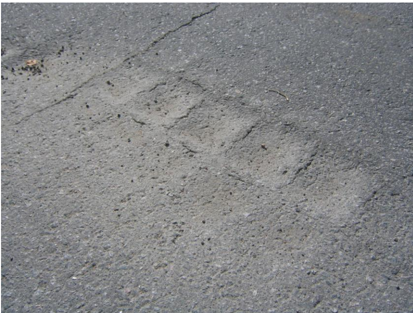
Bild 4. Beläggningens underbyggnad har givit efter.
