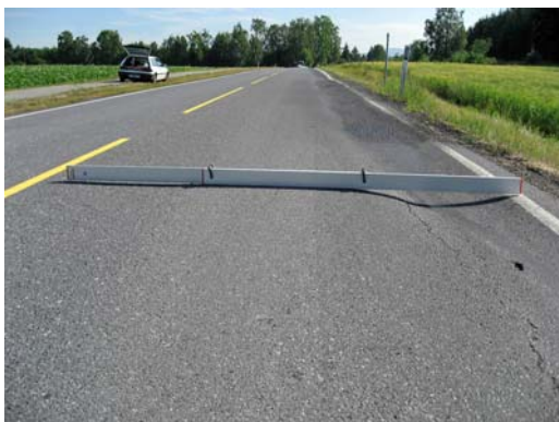
Hjulspor som ikke skyldes piggdekkslitasje -
