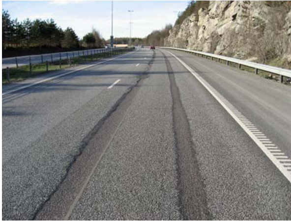
Gjennomslitt asfalt på Norges hovedveger E6 Gardermoen 2007
