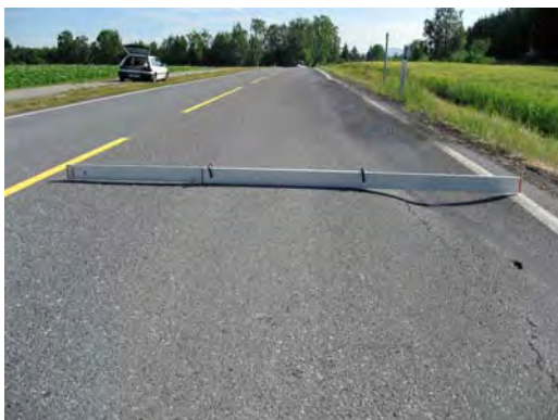
Hjulspor som ikke skyldes piggdekkslitasje -
