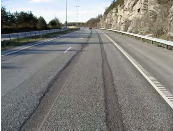
Gjennomslitt asfalt på Norges hovedveger E6 Gardermoen 2007
